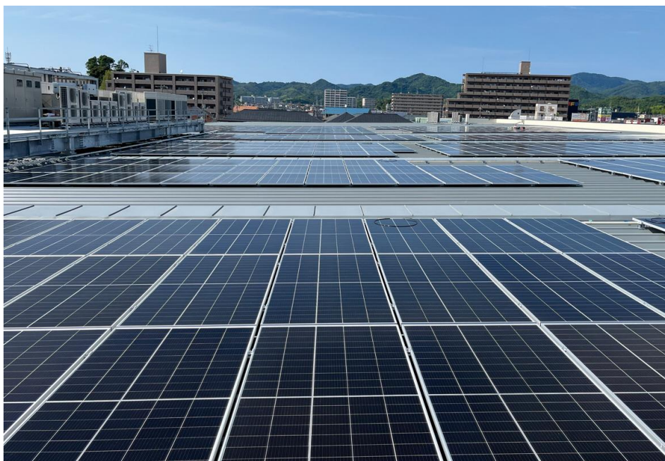
2024年5月新設 (松江：マルイ黒田店) 最大規模 (340kW) 太陽光発電所
